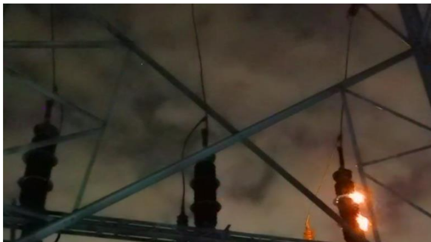
南岑1926线36#塔海缆终端污闪爬电
